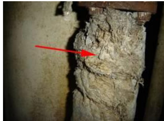
foto 4: asbestkoord gewikkeld om leidingwerk
