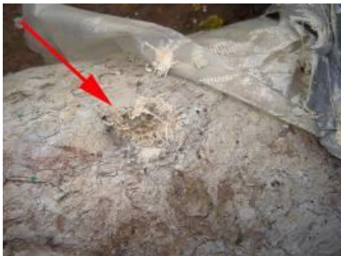
foto 5: leidingisolatie, is vaak niet hechtgebonden en zal veel vezels verspreiden bij beschadiging
