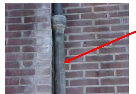
foto 30: asbesthoudende hemelwater afvoer.
