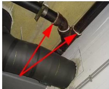
foto 12: asbesthoudend afdichtingskoord in mofverbindingen.
