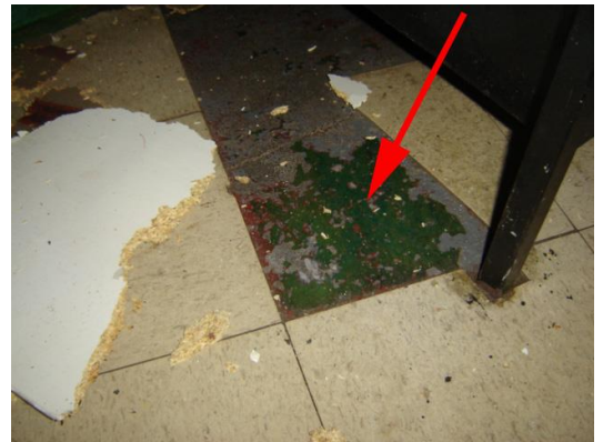
foto 16: asbesthoudende cement dekvloer.
