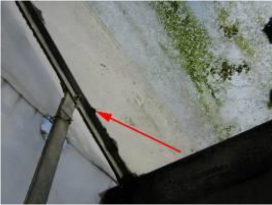
foto 13: asbesthoudende kit in de kassenbouw.
