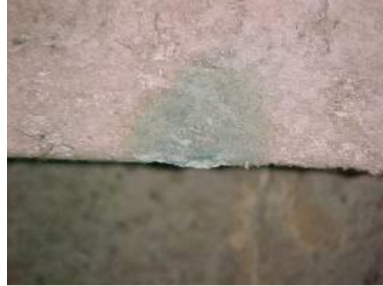
foto 8: spuitasbest op stalen constructie (monsterlocatie geïmpregneerd met blauwe vloeistof)
