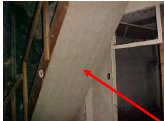
foto 20: asbesthoudende beplating tegen de onderzijde van de trap.
