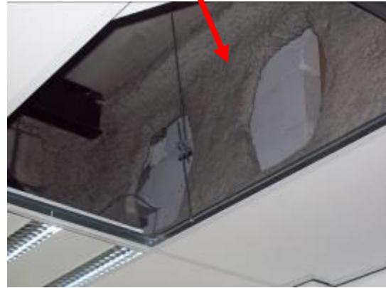
foto 32: asbesthoudende spuitisolatie tegen staalconstructie.
