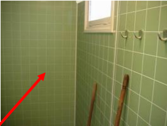
foto 19: asbesthoudende beplating met tegelmotief.
