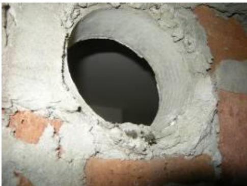
foto 11: asbestcement ontluichtingskanaal / doorvoer ingemetseld in muur
