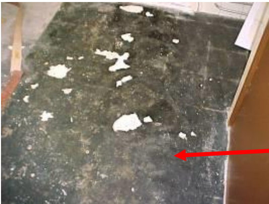
foto 33: asbesthoudende lijmlaag onder vloertegels.
