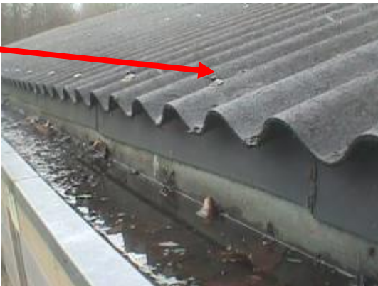
foto 3: asbesthoudende golfplaat, ook hoekstukken kunnen asbesthoudend zijn (asbestcement)
