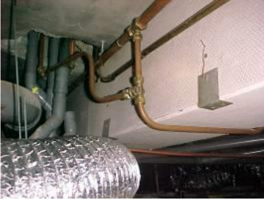
foto 7: vezelplaat met wafel/honingraat structuur als brandwerende toepassing om staalconstructie
