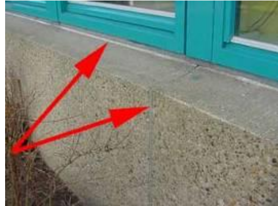
foto 14: asbesthoudende kit in dilatatievoegen en onder raamkozijnen.
