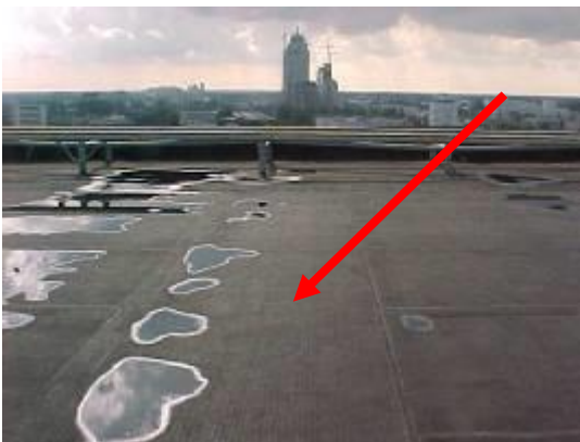
foto 27: asbesthoudende bitumen op daken. Dit kan ook aanwezig zijn als afstandhouder (voetje) van bliksemgeleiders op daken.
