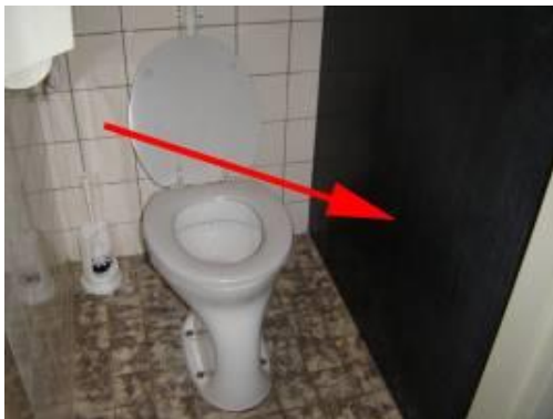
foto 35: asbesthoudend schaamschot (toilet privacy scherm).
