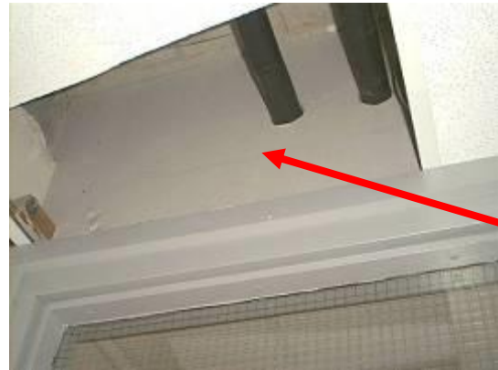
foto 26: asbesthoudende beplating als onderdeel van brandcompartimentering.
